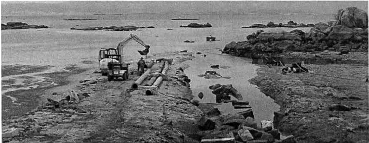
Ocultación de tuberías dunha depuradora en Punta Sinás
